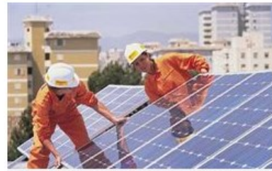
Εγκατάσταση φωτοβολταϊκών για την αξιοποίηση ηλιακής ενέργειας ( Φωτογραφία: ΑΠΕ )
